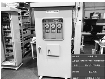
排水ポンプ制御盤
